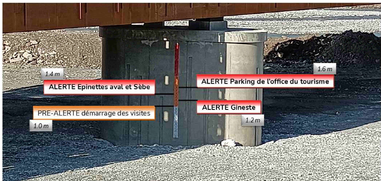
Figure 2 : Echelle du pont des Arches et niveaux
